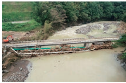
台風15号による和田島地区宮嶋橋(水管橋)の被災状況
