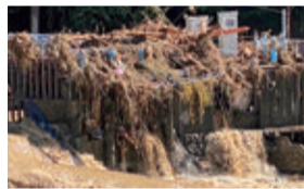
台風15号による承元寺取水口の被災状況
