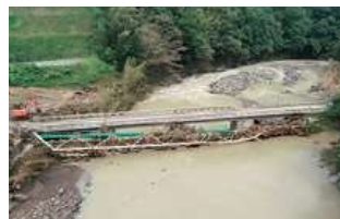
台風15号による和田島地区宮崎橋(水管橋)の被災状況
