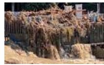
台風15号による成元寺取水口の被災状況
