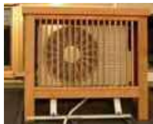
エアコン室外機カバー
