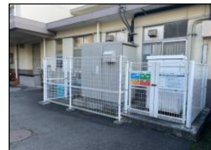
蓄電施設（大谷小学校）
