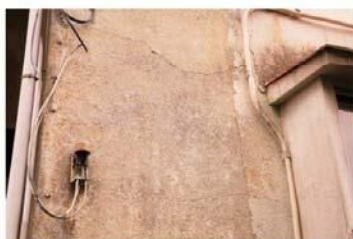
外壁のひび割れ ・コケ
