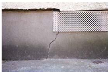
換気口付近の ひび割れ
