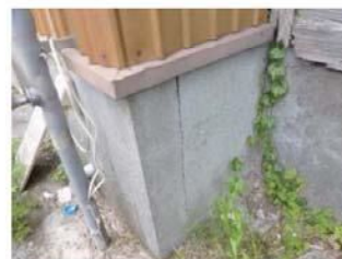
基礎の ひび割れ
