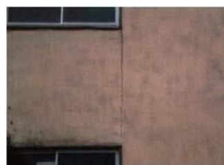
外壁の ひび割れ
