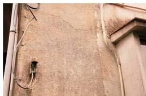
外壁のひび割れ・こけ
