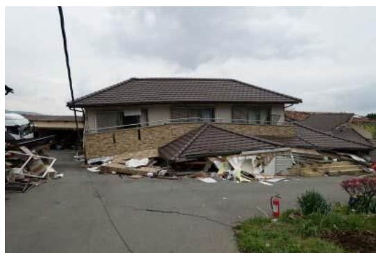
写真 16 倒壊した木造住宅
