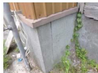
基礎の ひび割れ
