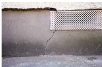
換気口付近の ひび割れ
