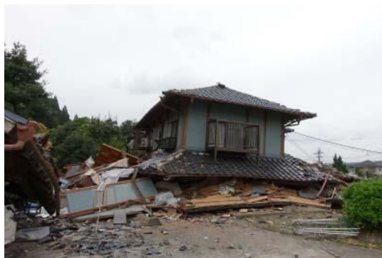
写真9 倒壊した木造住宅
