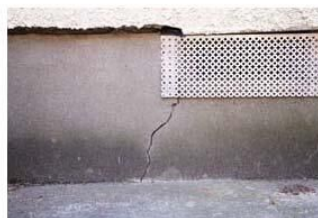
基礎のひび割れ
