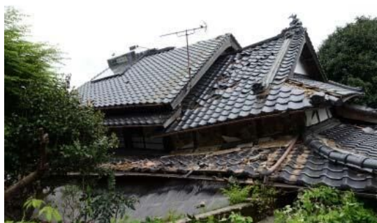
写真8 倒壊した木造住宅
