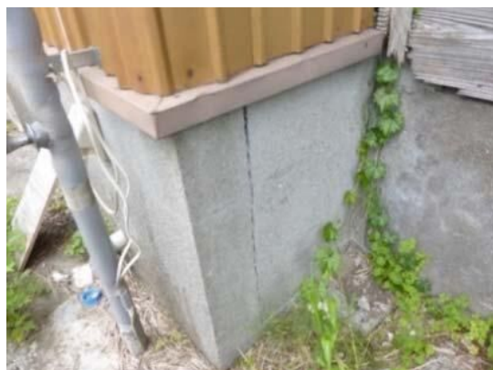
写真Ⅱ.2.3.3 基礎の割れ
