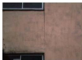
外壁の ひび割れ
