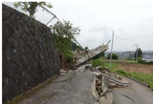
写真11 崩壊した擁壁
