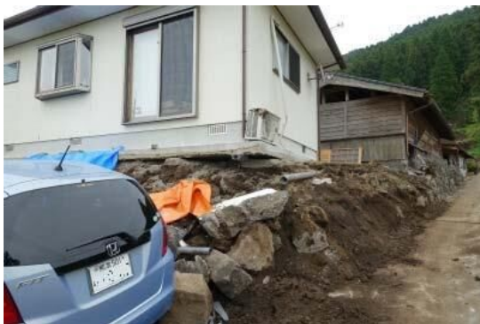
写真10 崩壊した擁壁
