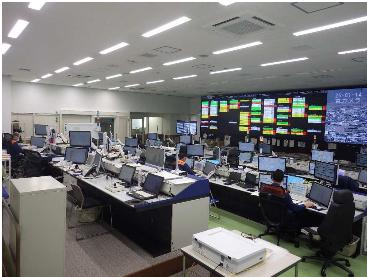
消防総合情報システム
