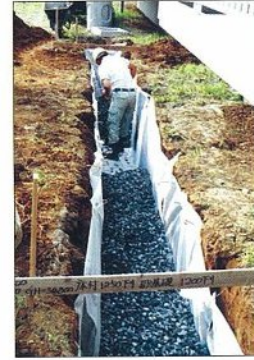
(浸透トレンチ)
