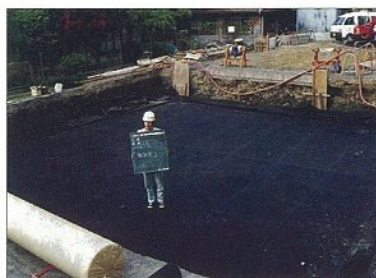
(空疎貯留浸透施設：プラスチック製品)
