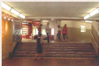
地下道の段差
