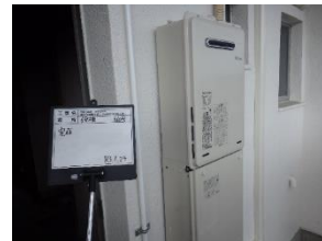
ガス給湯設備
