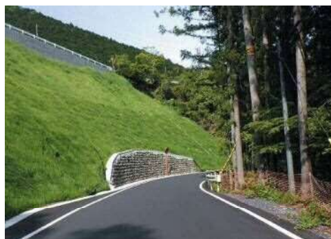
切土、植生マット、吹付砕工を実施し、道路利用者の安全を確保する
