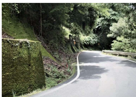
日常的に落石が発生している不安定な斜面
