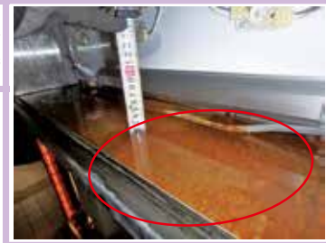
広告板底部の腐食、水抜き穴の不良状態
