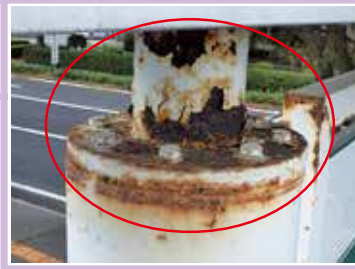
鉄骨接合部が腐食進行している状態
