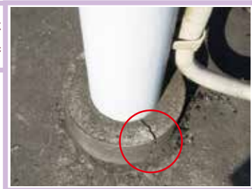
根巻きにクラックが入ると支柱との隙間がある状態
