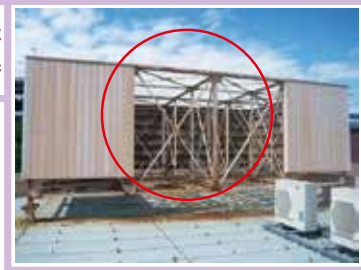
全体的に腐食し、劣化している状態
