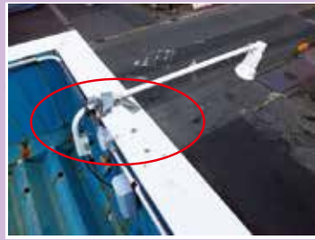
適切な設置方法がされていない状態
