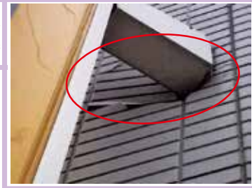
外壁が破損した状態
