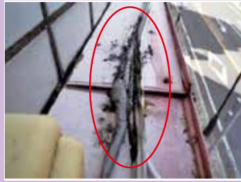
配線が劣化し、ショートした状態
