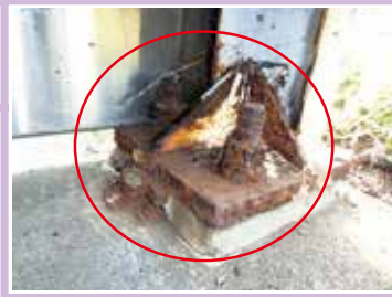
アンカーボルトが腐食している状態
