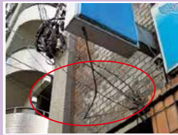
幕材を張る部材が破損した状態
