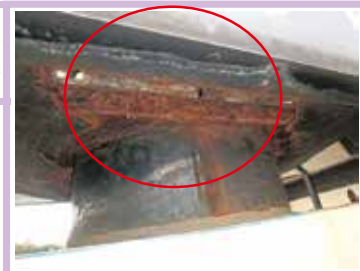
側板の腐食が進行した状態
