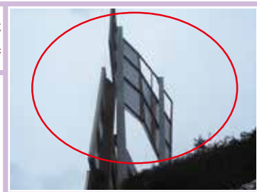
上部構造全体が傾斜した状態
