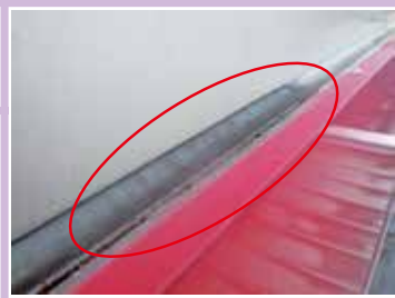
コーキングが劣化した状態
