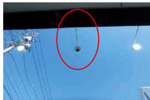
照明器具がショートし、不点している状態 →照明器具の、取替えが必要
