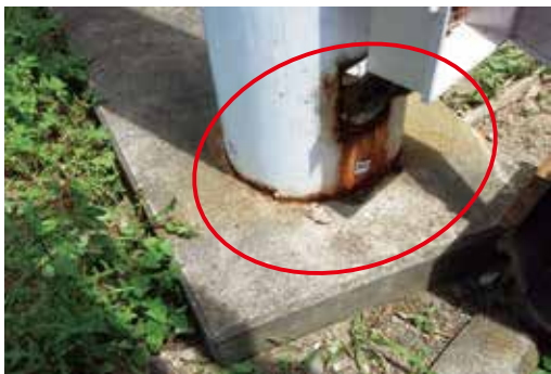
柱根元の腐食が進行している状態 →強度の確認が必要
