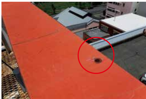
額縁の固定ビスが腐食した状態 →ビスの取替えが必要
