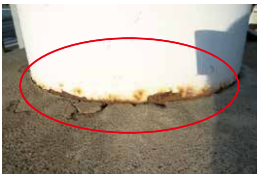
柱と基礎部の隙間が空いている状態 →錆の除去、根巻きの補修が必要
