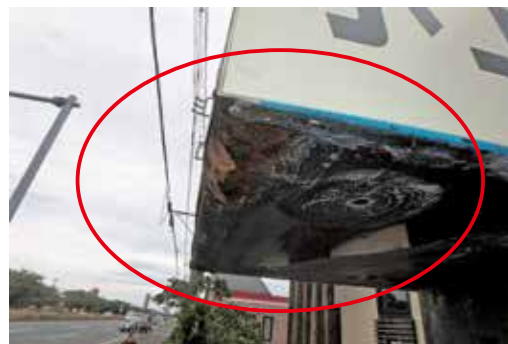
腐食で側板が欠損した状態 →部材の取替えが必要
