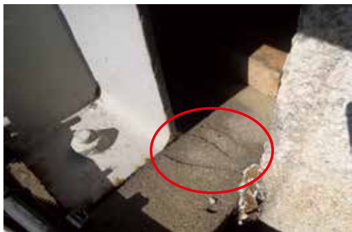
基礎部のクラックにより、滞水しやすい状態 →クラック深度を確認し、クラックを塞ぐ
