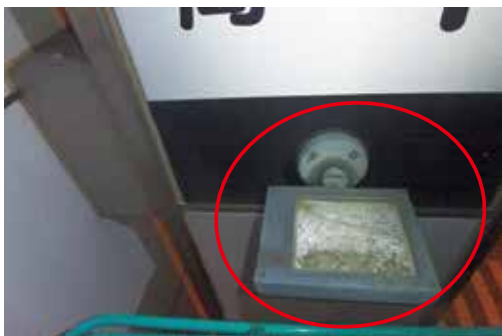
器具内部の滞水による不点灯 →器具の防水処理、取替えが必要
