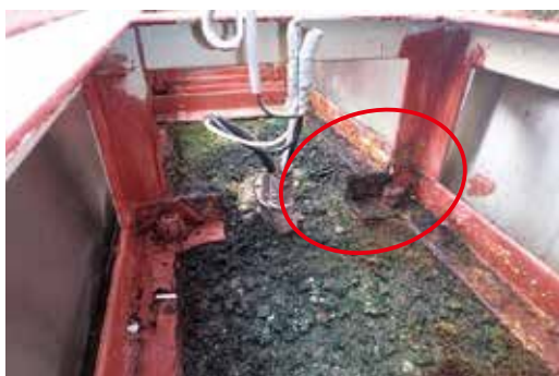
内部鉄骨の腐食が進行し、劣化した状態 →強度の確認が必要
