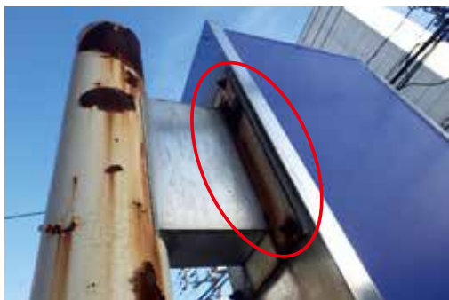
プレートが腐食が進行し、劣化した状態 →強度の確認が必要
