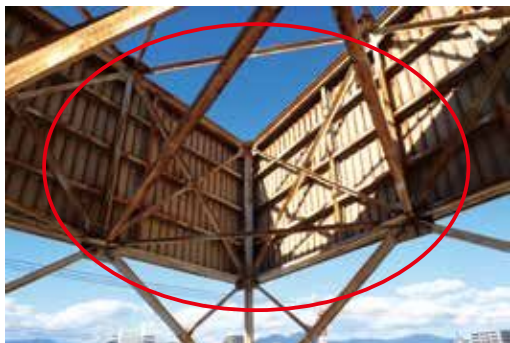
鉄骨全体に錆が発生し、劣化した状態 →錆を除去する
