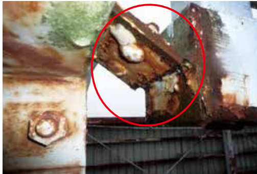
水平材接合部が自重により、変形した状態 →部材の取替えが必要
