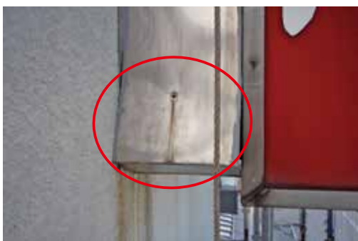
リベットの破断によるカバーのぐらつき →新規のリベット打ちが必要
