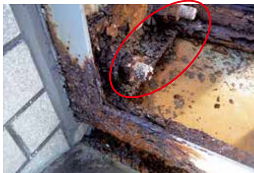
アンカーボルトの腐食が進行した状態 →撤去・取替えが必要
