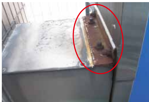
接合部のアングル、ボルトナットの腐食が進行した状態 →強度の確認が必要
