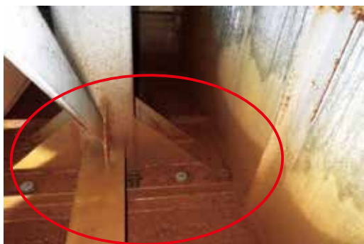
水抜き穴が無く、底部が全体的に腐食している状態 →部材の取替え、錆の除去、水抜き穴の開け直しが必要
