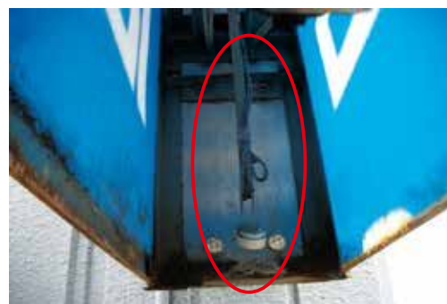
腐食により、照明器具が破損している状態 →器具の取替えが必要
