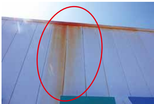
額縁が腐食し、面板に錆が垂れた状態 →部材の取替えを検討
