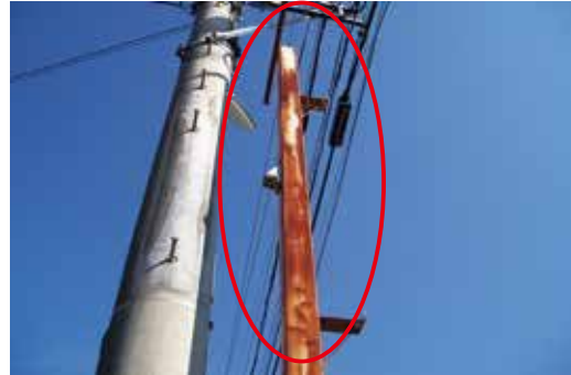
全体的に腐食が始まった状態 →撤去、取替えを検討
