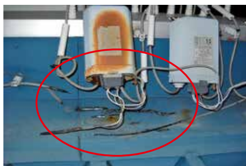
配線が焼損し、ショートした状態 →配線の取替えが必要
