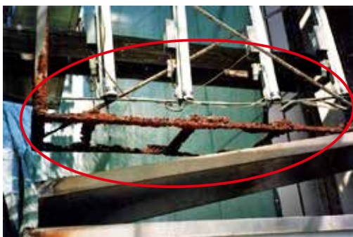
滞水により腐食が進行した状態 →撤去・取替えが必要
