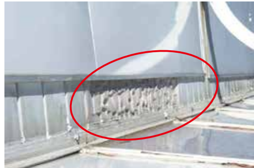
面板押えが変形した状態 →部材の取替えが必要
