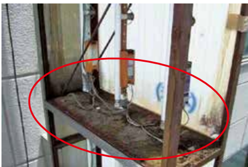
全体的に腐食し劣化している状態 →撤去・取替えが必要
