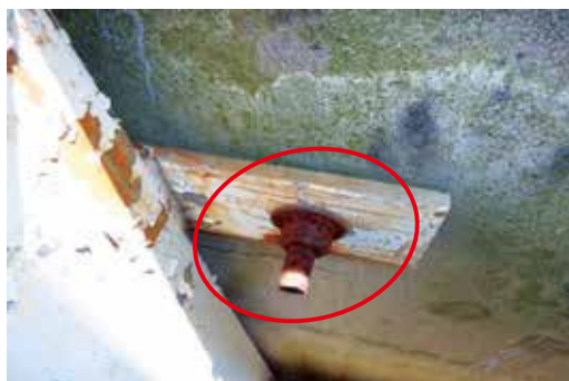
アンカーボルトが腐食し、劣化した状態 →強度の確認が必要
