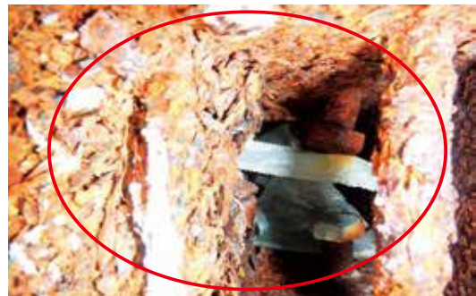
角パイプ内部、腐食が進行している状態 →強度不足の場合、撤去・取替えが必要
