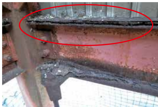
梁材の腐食が進行し、肉厚が減少した状態 →強度不足の場合、撤去・取替えが必要
