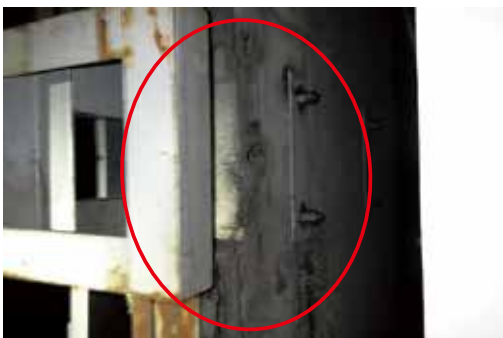
ブラケット固定ボルト周辺の外壁劣化 →原因調査と建築士に協議が必要
