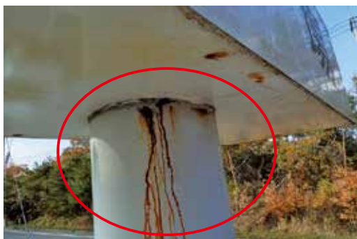
看板底部の腐食により、支柱に錆だれがある状況→看板内部の確認が必要
