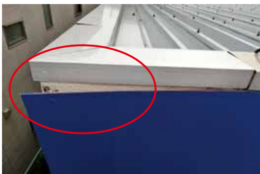
面板が浮いている状態 →ビス等による再固定が必要
