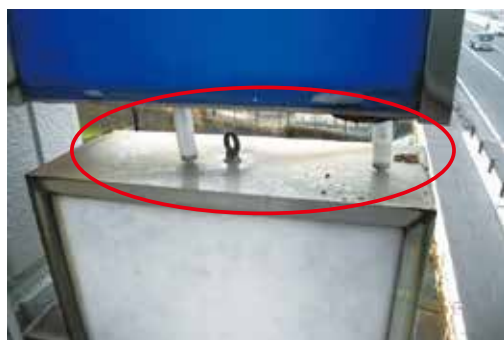
劣化により、側板底部及びランプが外れている状態 →該当部の作り直しが必要
