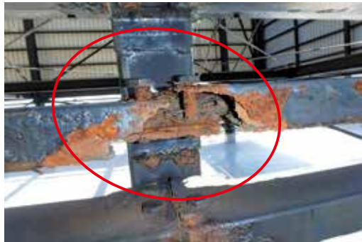
腐食の進行により、接合部が欠損した状態 →部材の取替えが必要
