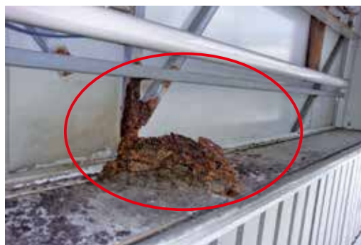
接合部のアングル、ボルトナットの腐食が進行し、劣化した状態 →撤去・取替えが必要
