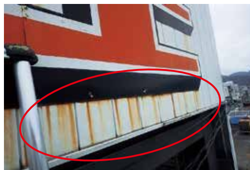
切板文字が劣化し、面板に錆が垂れた状態 →錆を除去する
