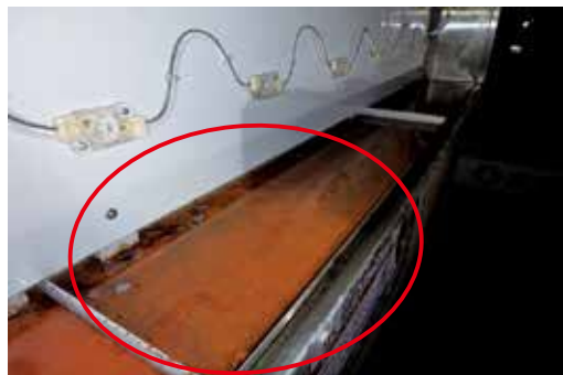
看板底部の滞水による腐食進行している状態 →錆・水の除去、水抜き穴の穴開けが必要
