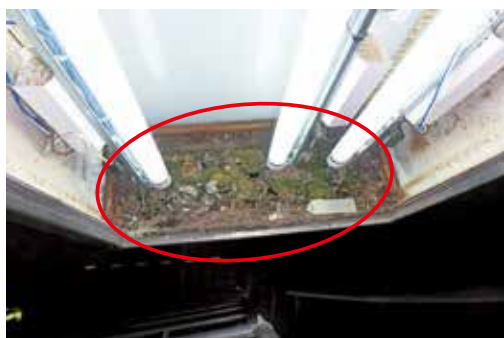
苔・錆により、水抜き穴が塞がった状態 →苔・錆の除去、水抜き穴の開け通しが必要
