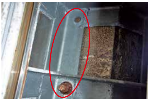
アンカーボルトの欠損及び腐食により劣化した状態 →新規ボルトナットの取付、取替えが必要
