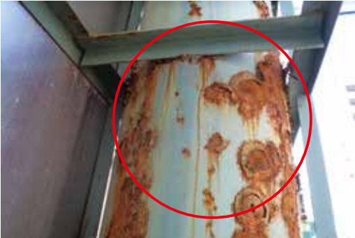
支柱の腐食が進行し、劣化している状態 →錆の除去、防錆処理が必要
