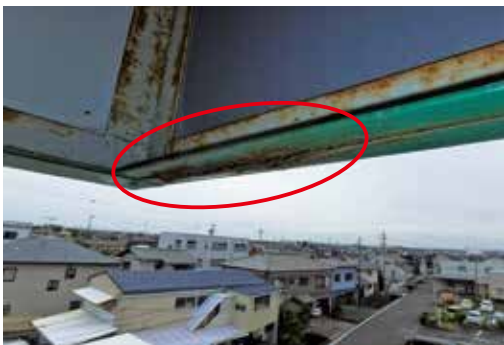
腐食により、劣化した状態 →部材の取替えが必要
