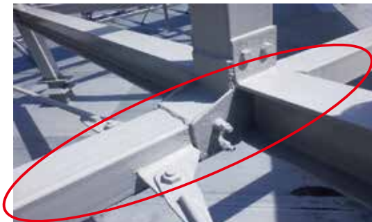
角パイプを水平材に使用。塗装されて外観は良好な状態。 (パイプ内部は右写真)
