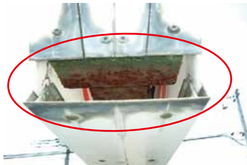
ビスの劣化により脱落している状況 →撤去・取替えが必要
