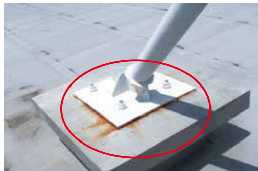
ベースプレートの腐食により、シート防水が劣化した状態→ 防水の施工業者と協議し対処する
