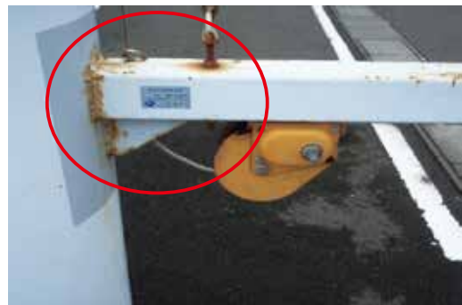
支柱との溶接部の劣化が始まった状態 →錆の除去、防錆処理が必要
