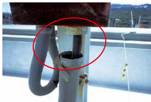
電気配管が脱落した状態 →つなぎ直す又は取替えが必要
