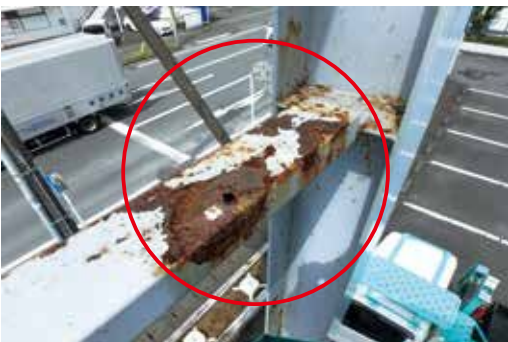
腐食が進行し、穴があいた状態 →部材の取替えが必要
