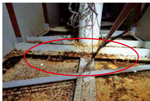
内部鉄骨の腐食が進行し、劣化した状態 →錆の除去、防錆処理が必要
