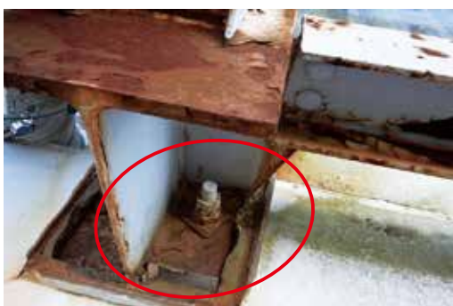
ボルト周囲の腐食が進行した状態 →強度の確認及び錆の除去が必要
