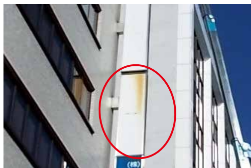
看板の劣化により、面板が汚損した状態 →清掃・取替えが必要
