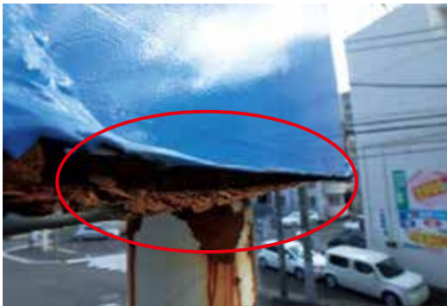
腐食により、隙間が出来た状態 →撤去・取替えが必要
