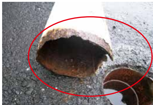
腐食により、柱が破断した状態 →撤去・取替えが必要
