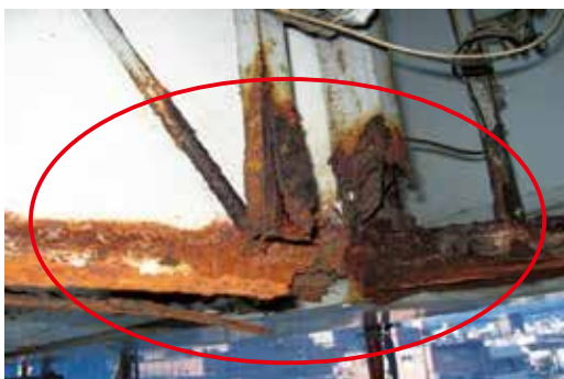
プレートが腐食が進行し、劣化した状態 →撤去・取替えが必要
