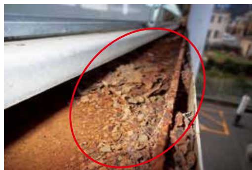
滞水により、腐食が進行している状態 →部材の取替えが必要
