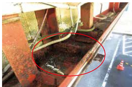
苔・錆により水抜き穴がふさがった状態 →苔・錆の除去、水抜き穴の穴開けが必要
