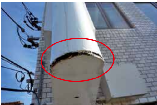
腐食により隙間が出来た状態 →部材の取替えが必要
