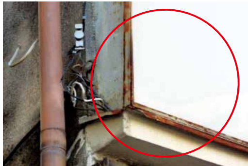
面板押えが腐食・変形した状態 →撤去・取替えが必要
