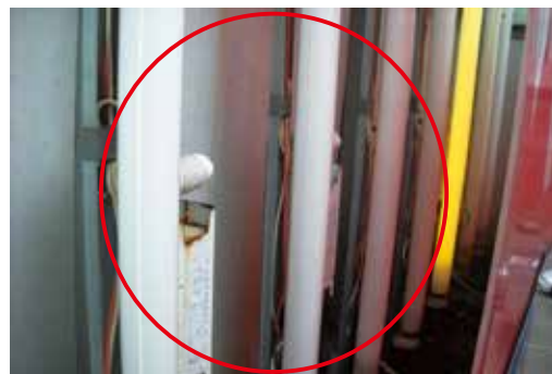
内部蛍光灯の不点灯 →蛍光灯の取替えが必要
