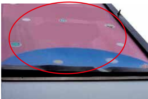
面板押えが変形した状態 →部材取替えや新たな固定方法の検討
