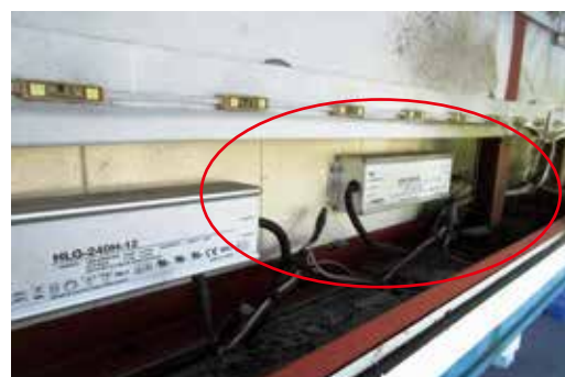
滞水による湿気により絶縁不良の状態 →器具の取替えが必要、換気設備の設置検討
