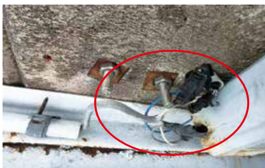
配線が劣化している状態 →配線の取替えが必要
