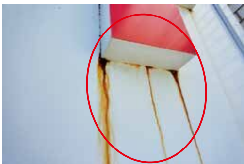
凸文字内部が腐食し、表面が変色した状態 →内部の確認、腐食部の取替え・修理が必要
