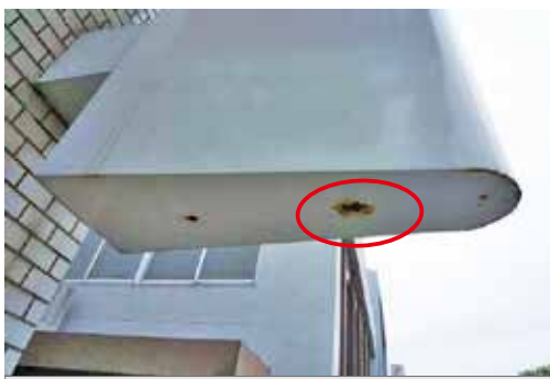
看板底部の腐食により、穴があいた状態 →看板内部の確認が必要
