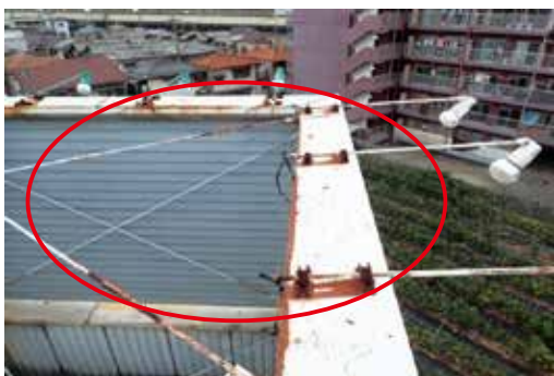
照明器具取り付け部が腐食した状態 →錆を除去し、取替えが必要
