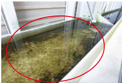
H型鋼の梁材に雨水が溜まった状態 →水抜き穴を開ける
