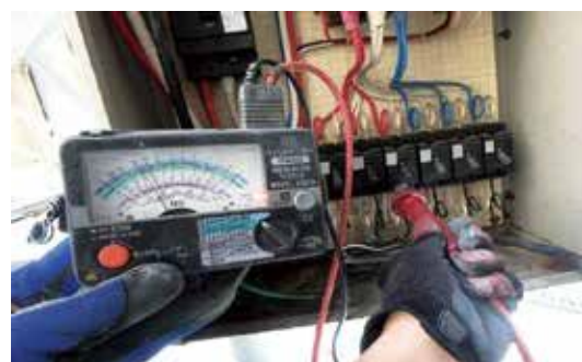
絶縁抵抗計にて漏電チェック →漏電が確認されれば原因の追求が必要
