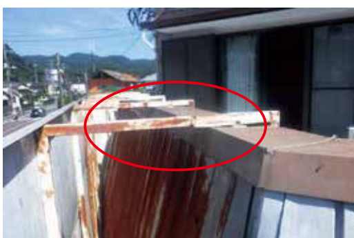
壁面看板補強材の腐食による劣化した状態 →補強材の取替えの検討
