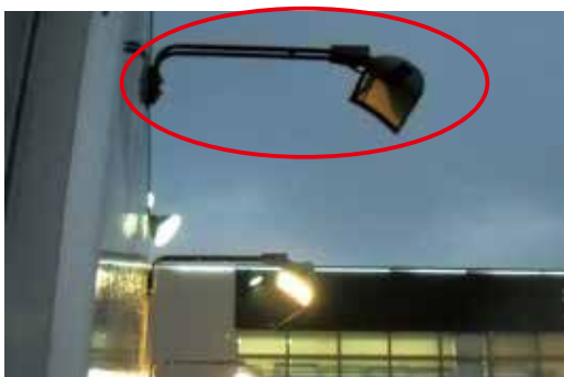
照明器具の不点灯 →照明の取替えが必要
