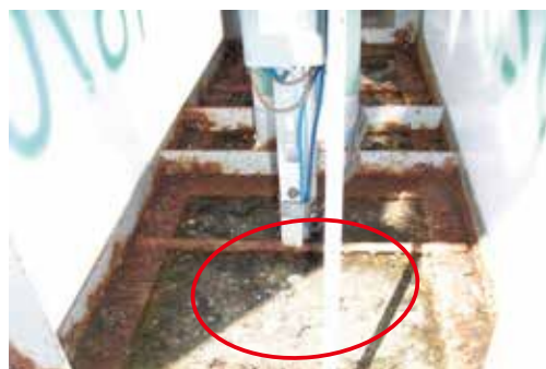
苔・錆により、水抜き穴が塞がった状態 →苔・錆の除去、水抜き穴の開け通しが必要
