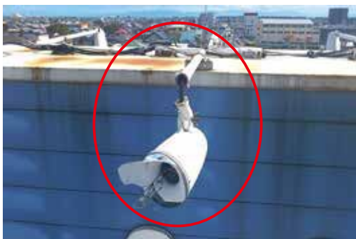
劣化により照明器具が脱落している状態 →器具の撤去、取替えが必要
