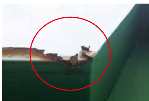
面板押えが腐食により欠損した状態 →部材取替えや修理が必要
