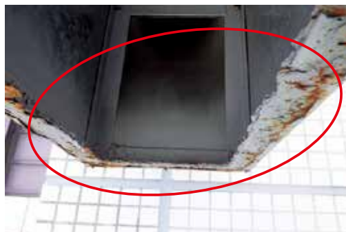
底部鉄骨の腐食により、欠損した状態 →撤去・取替えが必要
