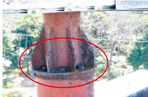
鉄骨の腐食が進行し、劣化した状態 →強度の確認、防錆処理が必要
