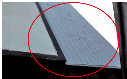
面板表面が劣化している状態 →面板の取替えの検討
