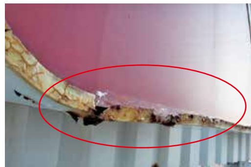
面板押え及び面板が劣化した状態 →撤去・取替えの検討
