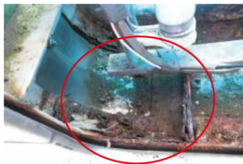
滞水により腐食が進行した状態 →水抜き穴の清掃、穴開けが必要
