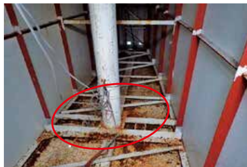
内部鉄骨の腐食が進行し、劣化した状態 →錆の除去、防錆処理が必要
