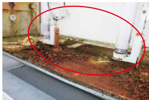
看板底部の滞水による湿気での絶縁不良 →水抜き穴の穴開け、部材の取替えが必要
