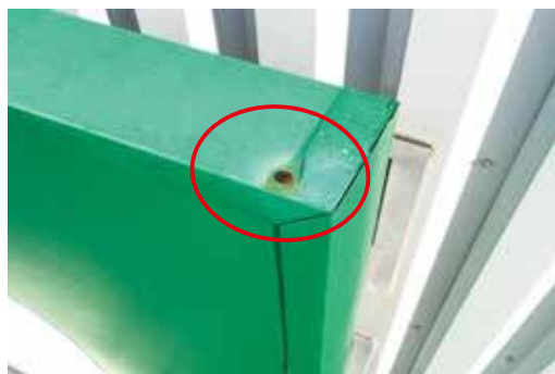
側板固定ビスが腐食した状態 →ビスの取替えが必要
