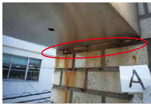
ブラケットの腐食により、外壁が汚損されている状態 →ブラケット内部の確認が必要
