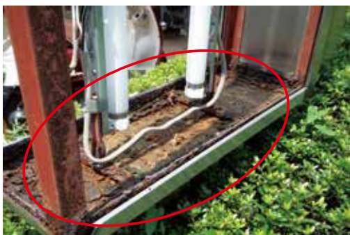
水抜き穴が無く、滞水により腐食が進行した状態→水抜き穴開けが必要
