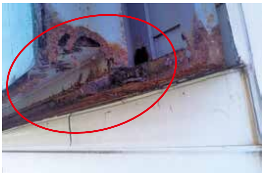
底部の腐食が進行している状態 →撤去・取替えが必要
