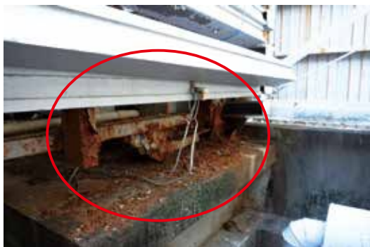
支柱根元の腐食が進行し、劣化した状態 →強度不足の場合、撤去・取替えが必要
