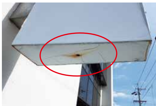
内部の腐食により水抜き穴周りを変色した状態→腐食状況の確認が必要
