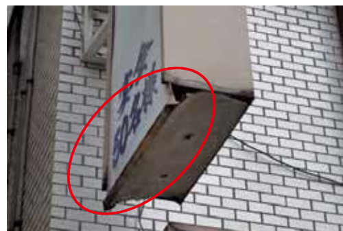
看板本体の劣化により、面板が落下しそうな状態 →面板の取替えが必要
