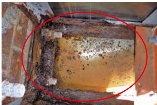
ブラケットの腐食が進行し、劣化した状態 →撤去・取替えを検討
