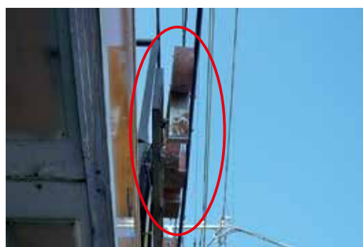
文字固定ビスの腐食により文字が脱落している状態→撤去・取替えが必要
