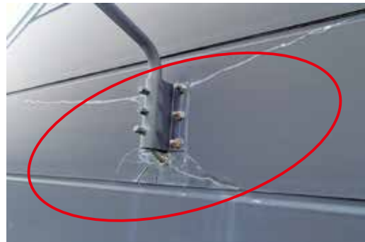
外壁にクラックが入った状態 →建築物の撤去、外壁の取替えの検討
