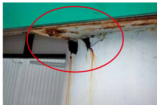
支柱・接合部付近が腐食している状態→強度の確認が必要
