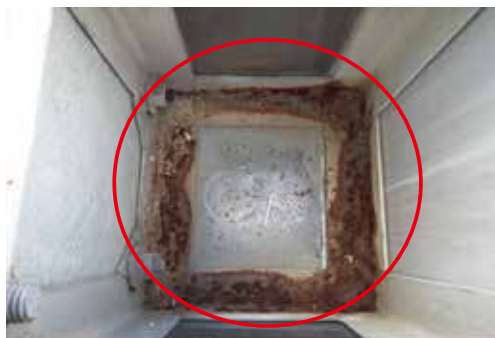
ブラケットの腐食が進行し、劣化した状態 →部材取替えが必要
