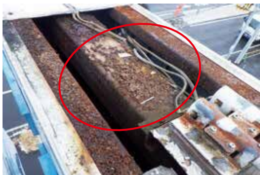
内部鉄骨の腐食が進行し、劣化した状態 →強度の確認、撤去・取替えを検討
