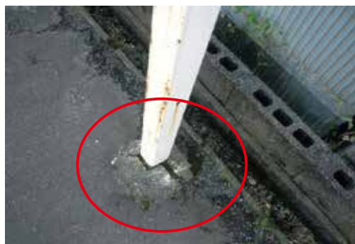
根巻きが割れ、柱根元が腐食しやすい状態 →根巻きの補修が必要
