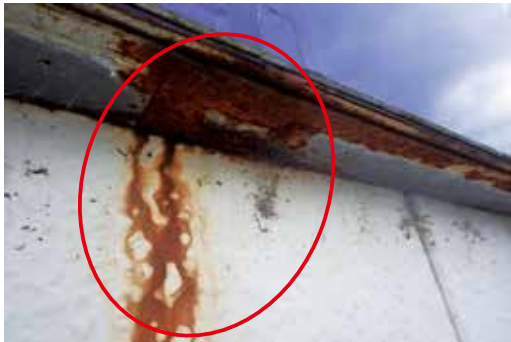
錆だれにより外壁を汚損した状態 →錆の除去、防錆処理が必要
