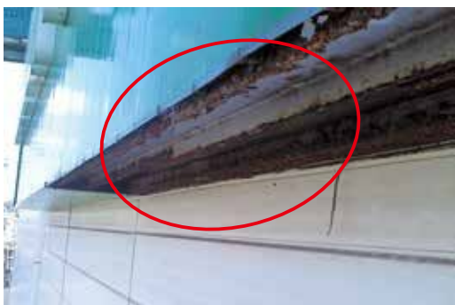
鉄骨の腐食により、側板底部が脱落した状態 →撤去・取替えが必要
