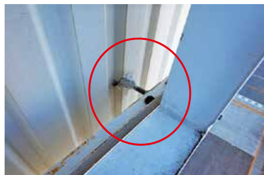
アンカーボルト周囲のコーキングが劣化した状態→シーリングの打ち直しの検討
