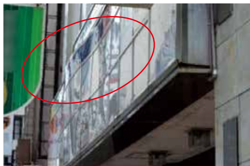
面板が変形し、劣化した状態 →撤去・取替えの検討
