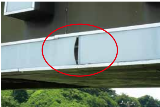
面板が変形し、欠損した状態 →面板の撤去、取替えが必要
