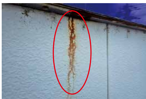
外壁への錆だれ →看板内部の確認が必要
