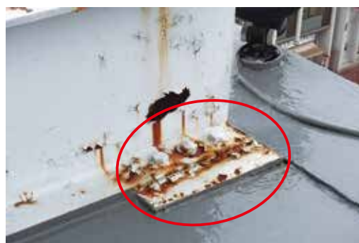
ボルト周囲が腐食し始めた状態 →錆の除去及び防錆処理が必要
