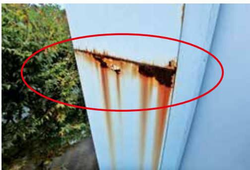
側板つなぎか腐食により、劣化した状態 →錆の除去、防錆処理が必要
