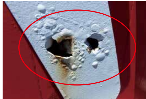
凸文字内部の腐食により、穴があいた状態 →撤去・取替えが必要
