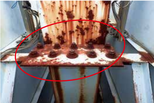
鉄骨の腐食が進行し、劣化した状態 →強度の確認、防錆処理が必要
