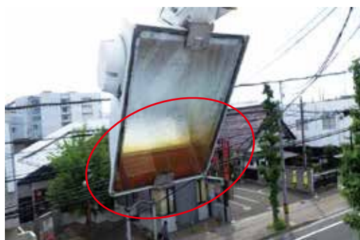
照明器具内部の滞水よりランプが不点している状態→器具の取替えが必要
