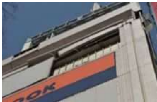
[ 写真 (2) : 実際に落下しなかった看板 ]
