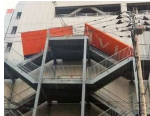
[写真(4)：落下した看板]
