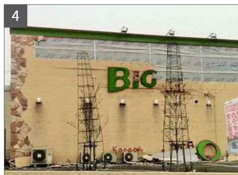
ALC 板と看板が落下している
