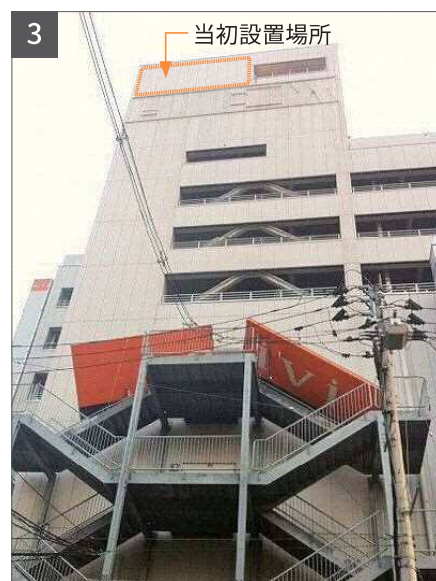
落下した看板
