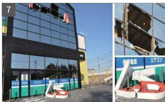
看板とガラスが落下
