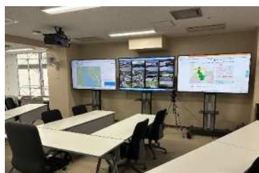
【災害対策本部等機能強化事業】大型モニターや会議配信用の放送設備導入などに活用しました。
