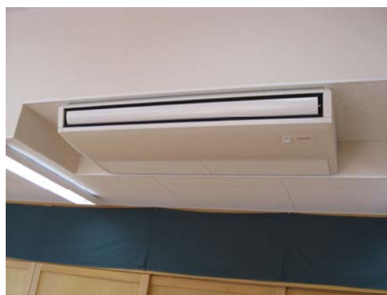
空調設備設置例
