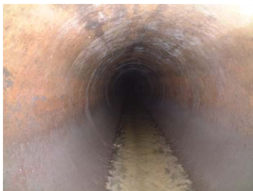
老朽化した下水道管
