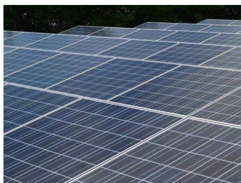
太陽光パネル
