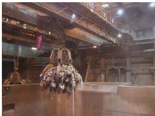
ごみクレーン
