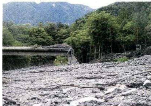
林道井川雨畑線の被災状況
