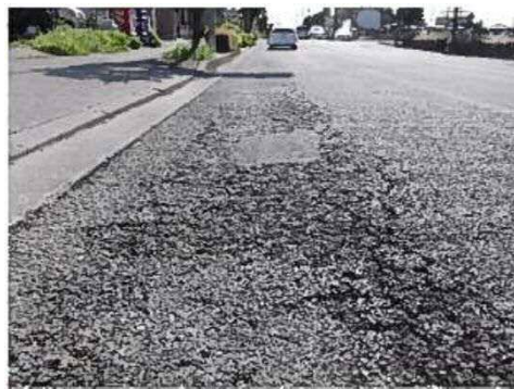
舗装のひび割れが進んでいる箇所の例
