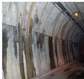
トンネル内の漏水状況
