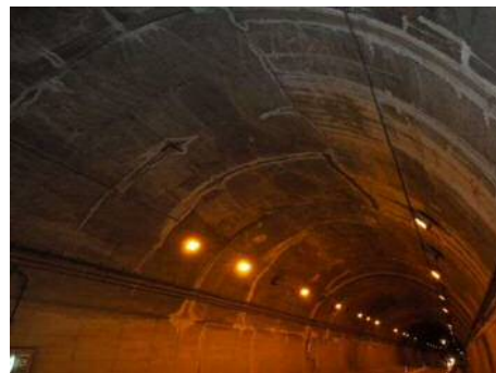
トンネル本体にひび割れが生じている箇所の例
