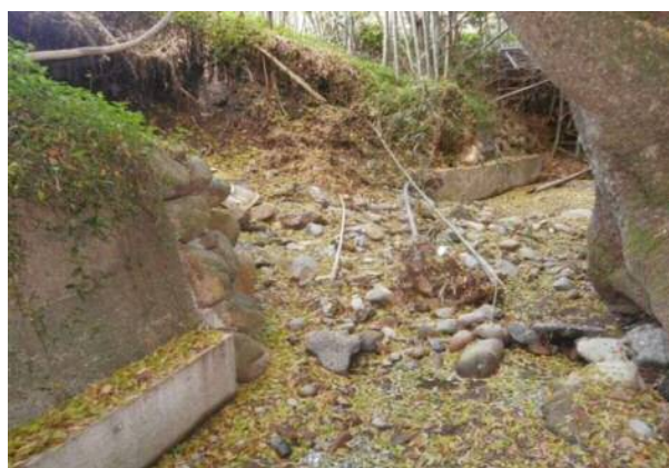
損傷した河川の様子
