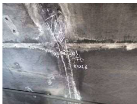
トンネル本体に浮き及びひび割れが生じている箇所の例
