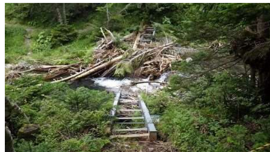
登山道崩壊箇所
