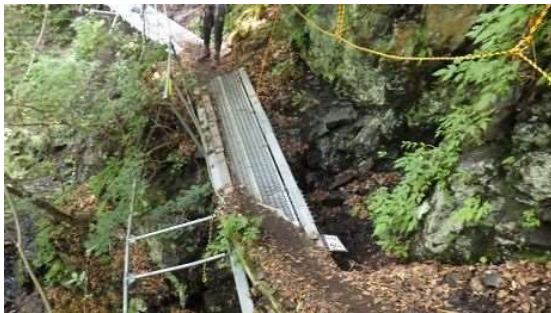
登山道崩壊箇所
