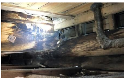
雨漏りによる梁等の腐食
