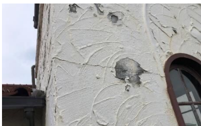
外壁の剥離やクラック
