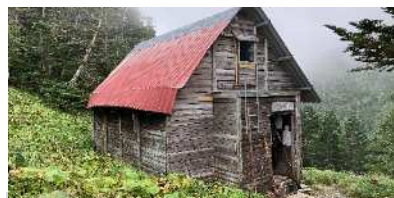
老朽化した高山裏避難小屋
