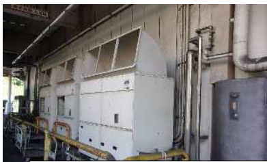
室外機（スクロール冷凍機）
