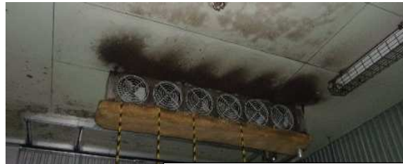
室内機（ユニットクーラー）
