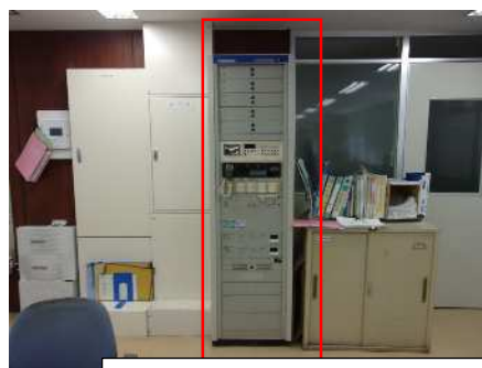
ラック型非常用放送設備
