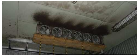
室内機（ユニットクーラー）
