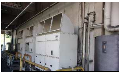
室外機（スクロール冷凍機）
