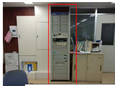
ラック型非常用放送設備
