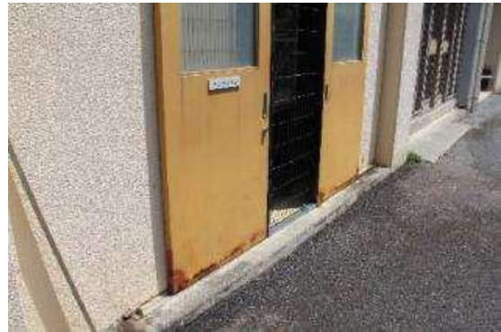
(建具の劣化状況)
