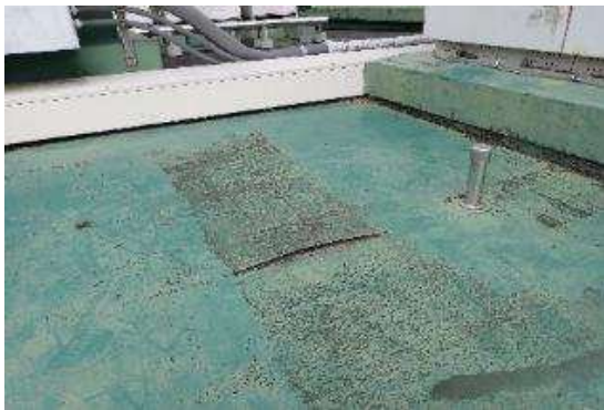
(屋上防水の劣化状況)
