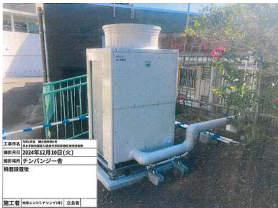
(類人猿舎 室外機)
