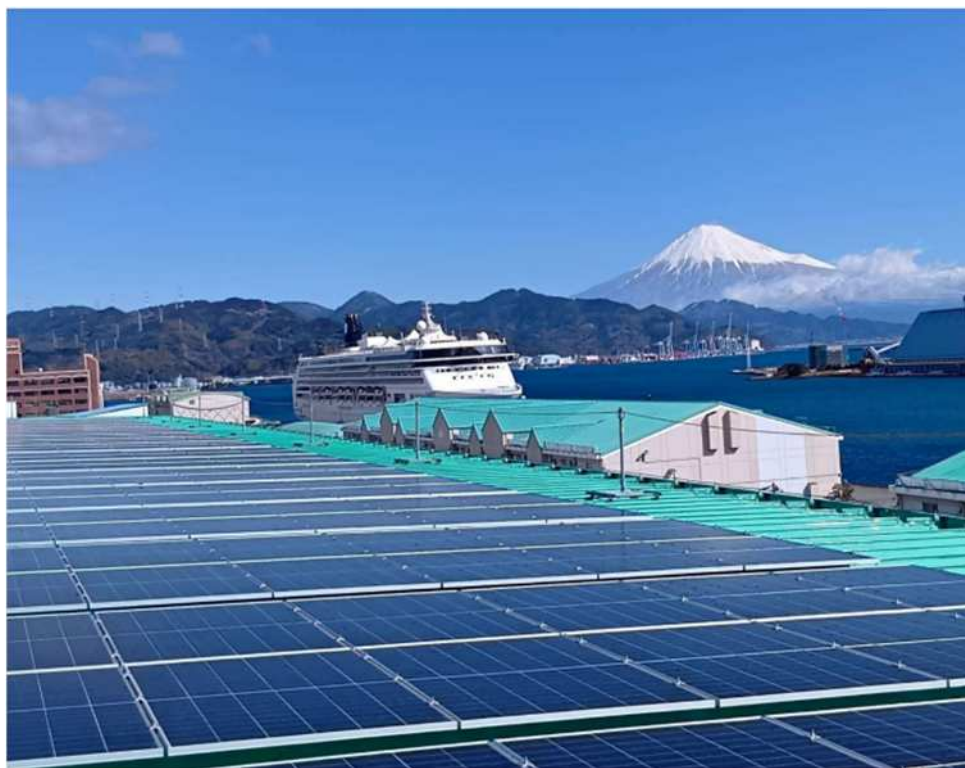
<太陽光発電設備>
