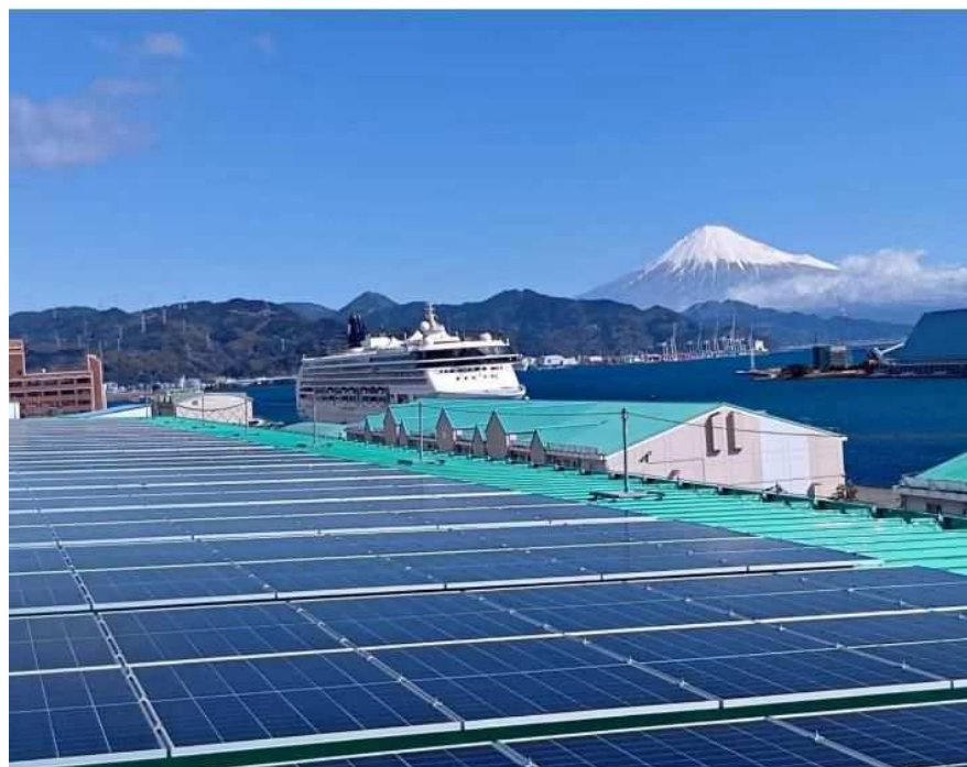
<太陽光発電設備>
