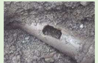
老朽化により破損した下水道管
