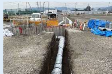
管の減災・老朽化対策
