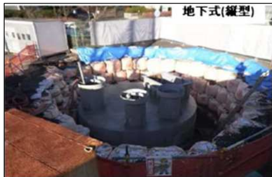
耐震性貯水槽(市内42基) 容量: 100t(38基) 60t(3基) 187t(1基)
