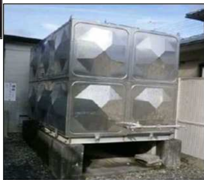
給水栓付受水槽(市内92基) 容量: 数十t
