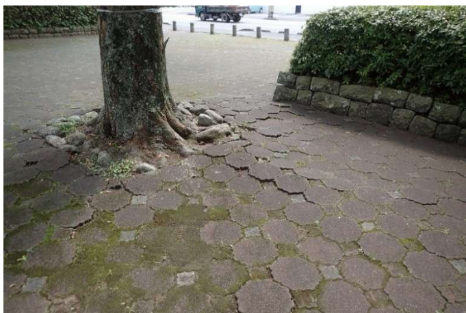
【写真 13：根上がりによる舗装の損傷】
