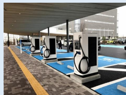
庁舎に設置されたEVスタンド(柏崎市役所)
