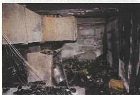
写真35 火点室の状況
