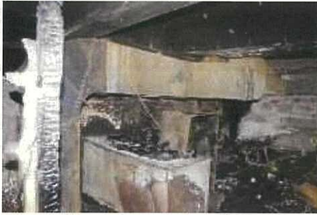
写真 36 ダクトの焼損状況
