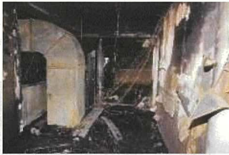
写真 27 ダクト周辺の状況 (図 19⑥)
