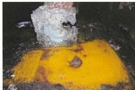
写真 41 出火箇所床面の状況
