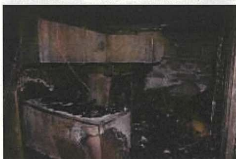
写真34 火点室の状況
