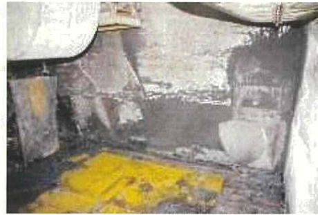
写真 37 南面の焼損状況
