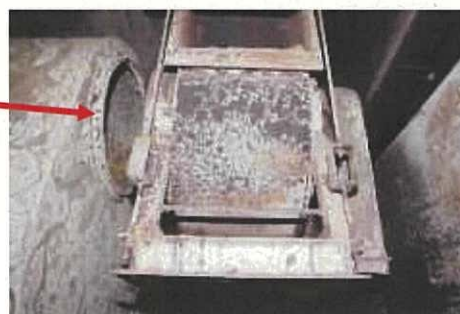
写真 62 ダクト繋ぎ目部分の空気流入箇所
