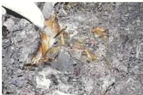
写真 40 出火箇所の状況
