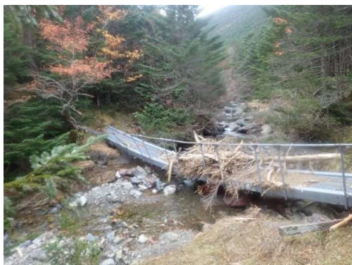
登山道崩壊箇所
