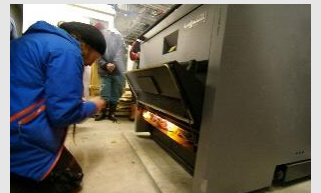
町内民間事業者が薪ボイラーを導入▲
