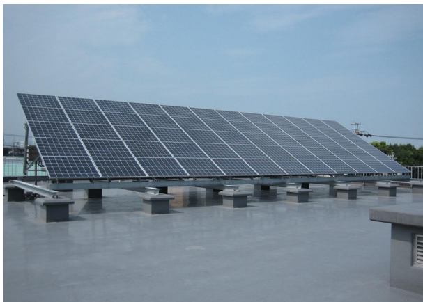
太陽光発電システム導入（西島配水場ほか）
