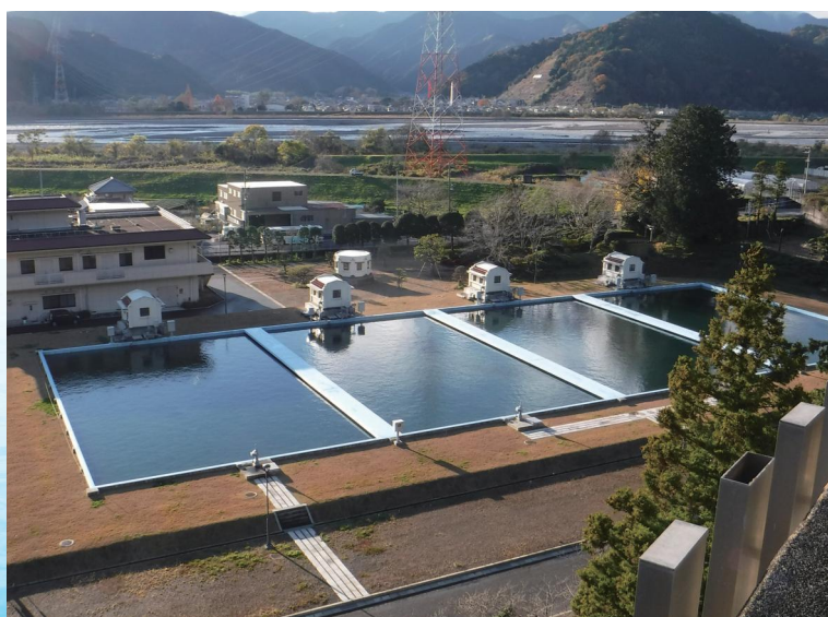
緩速ろ過施設
